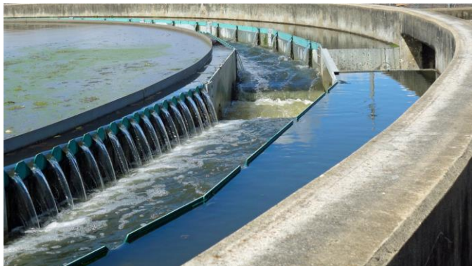
Kläranlage für kommunales Abwasser
